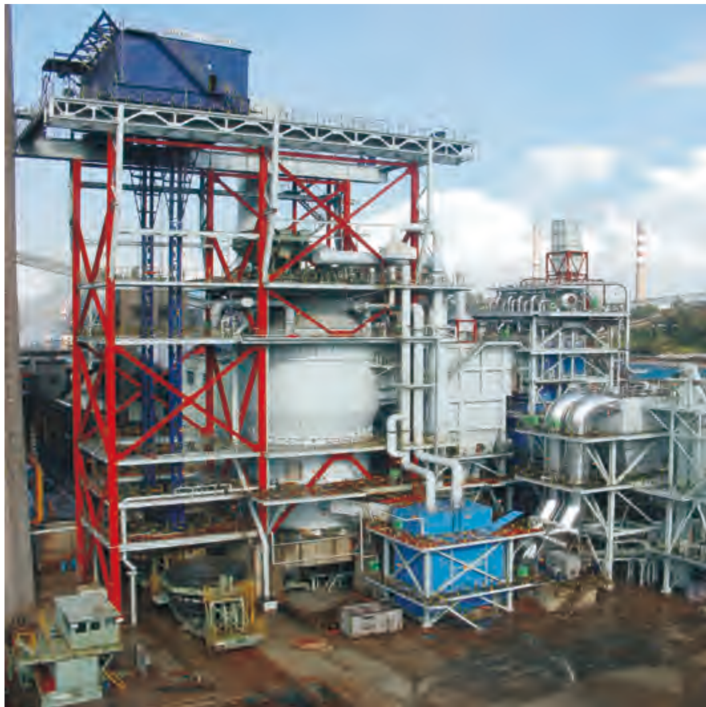
干熄焦提升机 Dry Quenching Lift
