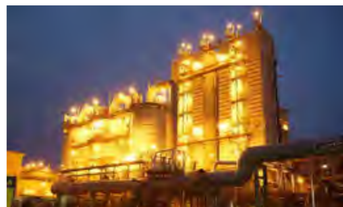
化产系统 Chemical System
