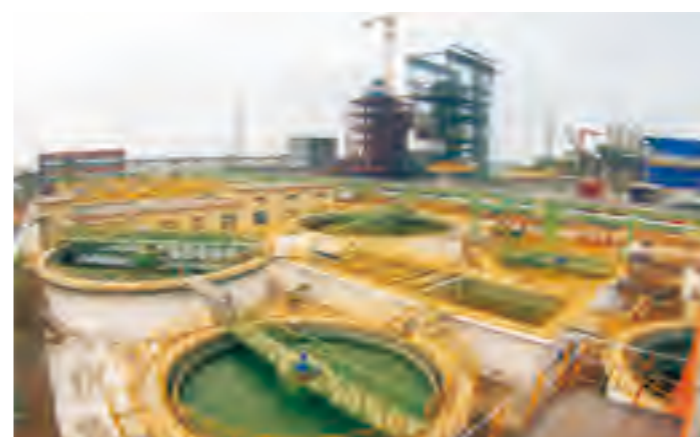
污水处理系统 Sewage Treatment System
